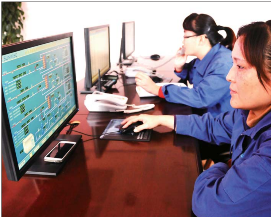
东郊热力公司控制大厅内,工作人员正在监控供热运行情况。本报记者 李岩松 摄
