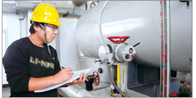
工作人员正对供热设备运行情况做记录。本报记者 邓兴宇 摄
