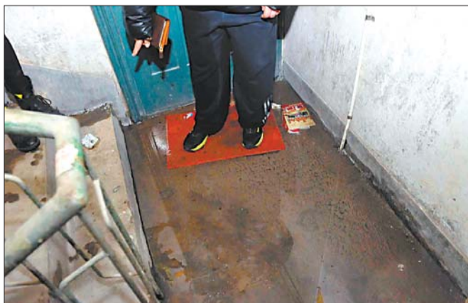
总闸关闭后,水流停止了,但楼梯间还存有积水。
