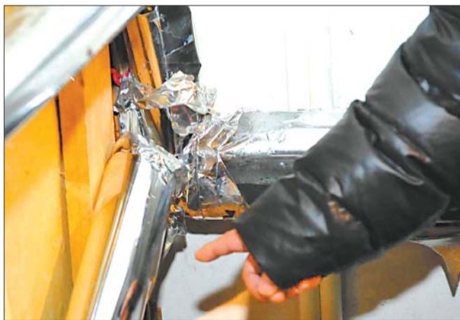
居民文先生指着管道的裂口说,管道就是在这里爆裂的,热水哗哗从4楼的楼梯间往下流淌。 本报记者 邱志强 摄
