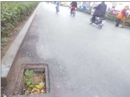
柳园路与东昌路交叉口西南角人行道上的缺盖窨井。本报记者 王瑞超 摄
