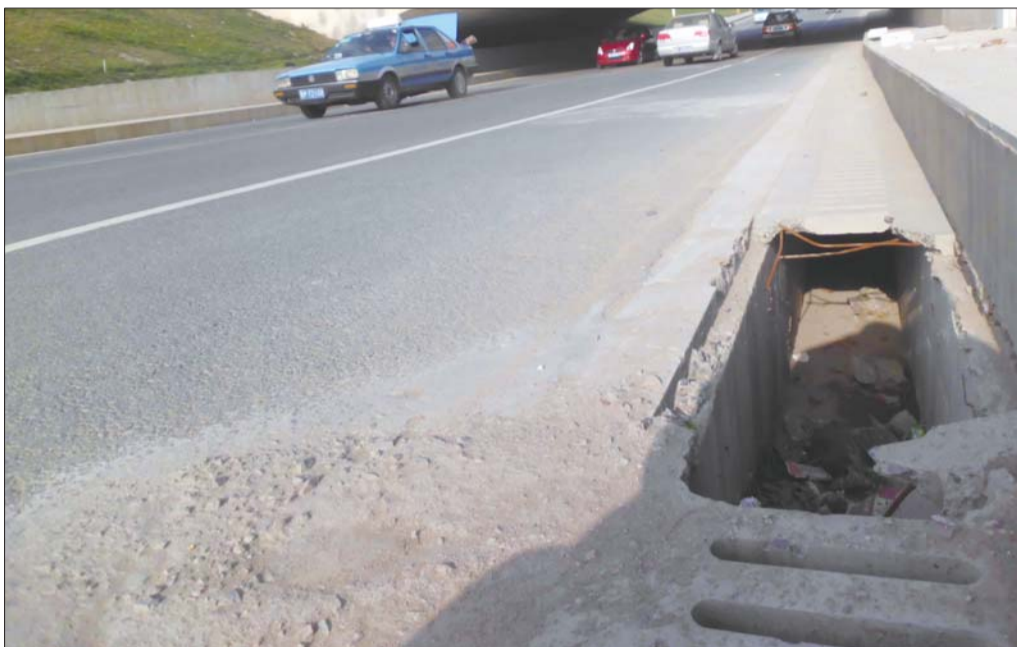
利民东路桥下滨河大道上的排水渠石板破裂形成大坑。本报记者 郭庆文 摄
