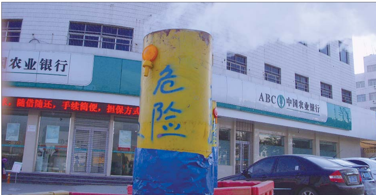
19日,在工业南路与奥体中路交叉口东南角,竖起的管道向外冒着蒸汽。
