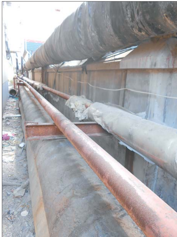
近百米供暖主管道暴露在外。 本报见习记者 梁越 摄
