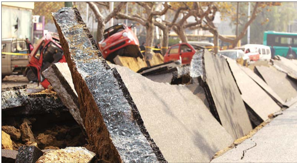
22日,青岛市经济技术开发区(黄岛区)发生输油管道爆燃事故,路面被损毁。凌晨3时,位于开发区秦皇岛路与斋堂岛街交会处的中石化管道公司输油管线破裂,原油泄漏。上午10时30分左右,管道公司和黄岛油库在清理油污过程中,开发区海河路和斋堂岛街交会处发生爆燃,距此地约1公里外的雨水管道末端入海口处发生原油燃烧。 新华社发
