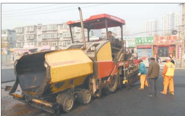
工人正在对山大路北段铺设沥青,快车道修整完毕,实现全线通车。 本报记者 蒋龙龙 摄
