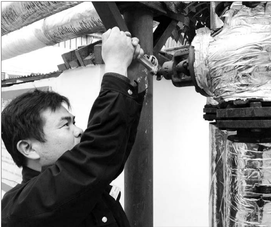
热力公司工作人员调节进入宾馆的暖气管道。本报记者 张林 摄
