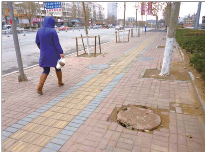
井盖破损后露出竹片,让人看了有些担心。本报记者 王伟平 摄
