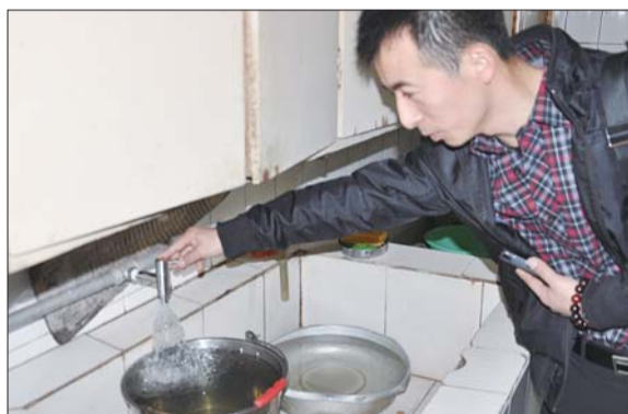
水龙头安装完成后,刘曲杰经理逐个试验,检验安装品质。 本报记者 蒋慧晨 摄
