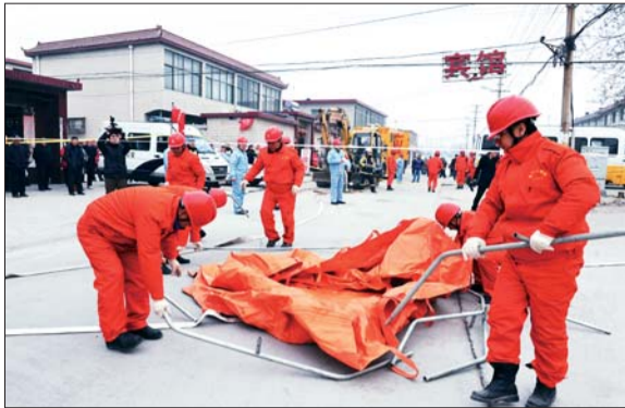
安装原油回收装置。
