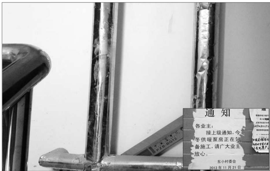
▲通往住户家的供暖管道全部安装完毕。▶物业办公室贴出的供暖泵房正在施工的通知。
