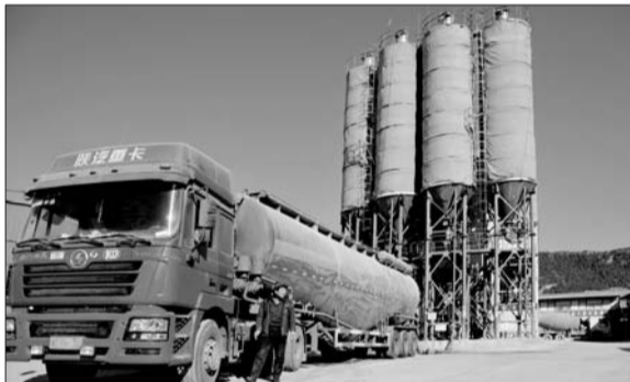
混凝土拌合站为隧道提供施工原料。 本报记者 王鸿哲 摄
