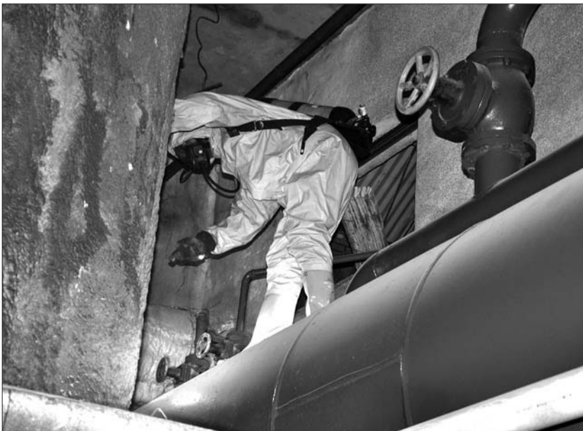
消防队员正在检查氨气泄漏点。
