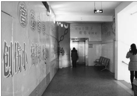
五层仅有一个疏散楼梯,数量不足。 本报记者 杨兵三 摄
