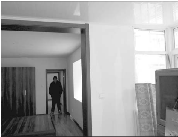
一楼季先生家中,墙面被水渗透了。本报记者 苑菲菲 摄
