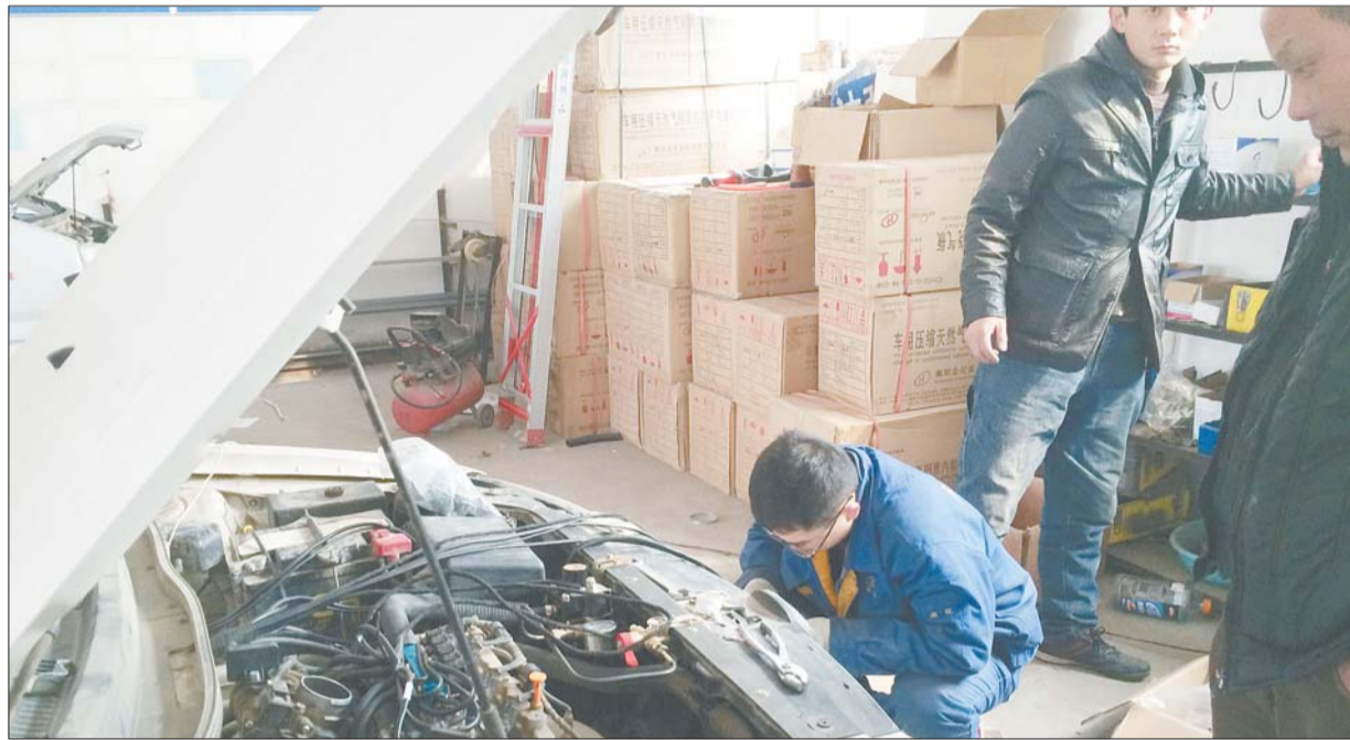
23日上午,在一家油改气改装厂,一辆私家车正在进行改装。 本报记者 喻雯 摄
