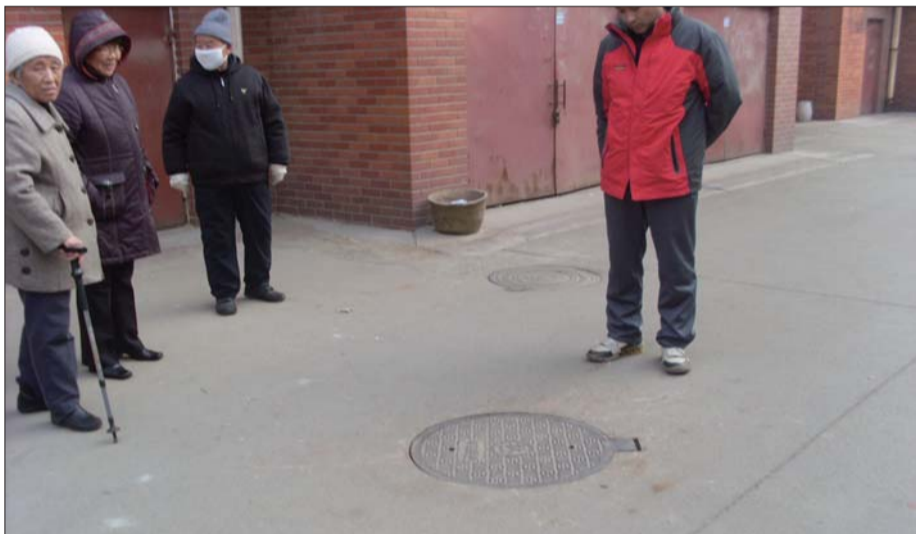
业主们向记者指出漏水管道的所在位置。 本报见习记者 臧振 摄
