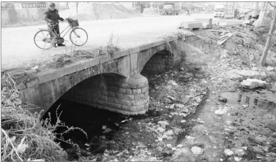
3米小桥没有护栏、路灯等防护设施。
