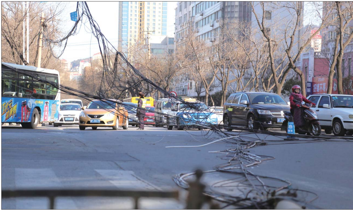
电缆坠落一地,路上出现短暂交通拥堵。本报记者 韩逸 摄
