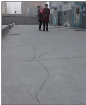
已有的居民楼前地面出现裂缝。 本报记者 张汝树 摄
