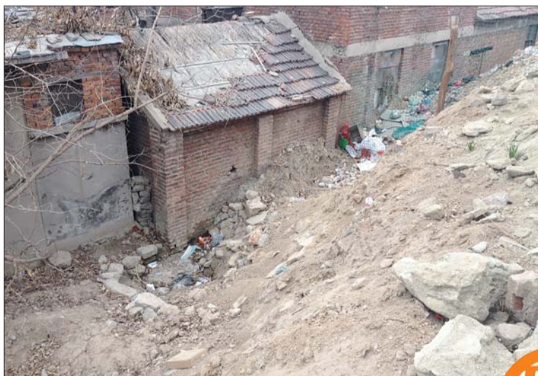
土堆高过院墙,张先生家里房屋受潮严重。本报记者 任磊磊 摄
