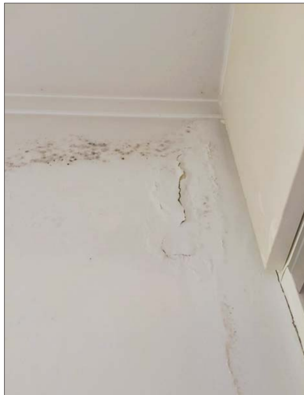
墙面上有明显渗水留下的痕迹。 本报记者 王倩 摄
