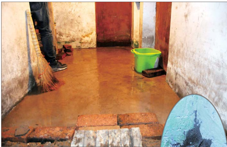
整个地下室都水淋淋的。 本报记者 孙国祥 摄
