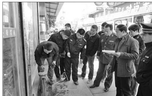
工作人员对香江光彩市场内公共灭火栓进行试水试压。 本报记者 郭庆文 摄
