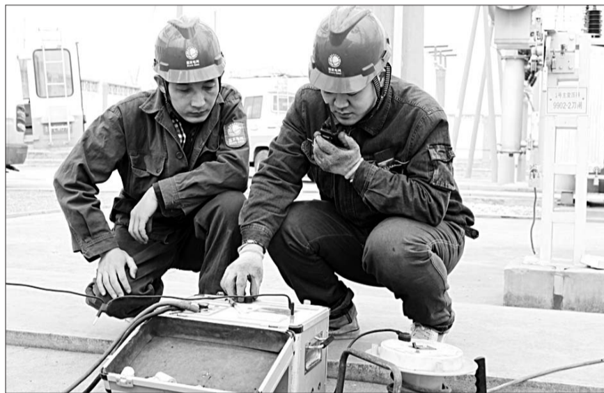
近日,邹城市供电公司陆续检修23座变电站和涉及输电线路的安全隐患,提前消除电力设备安全隐患。图为在邹城市35千伏匡庄变电站春检工作现场,检修工作人员正在测试二次设备继电保护定值比。 本报通讯员 朱璐 摄
