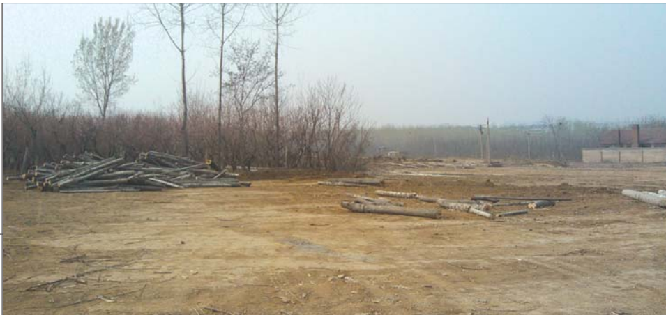
泰安一中新校区拟选址位置土地已开始平整。 本报记者 梁敏 摄
