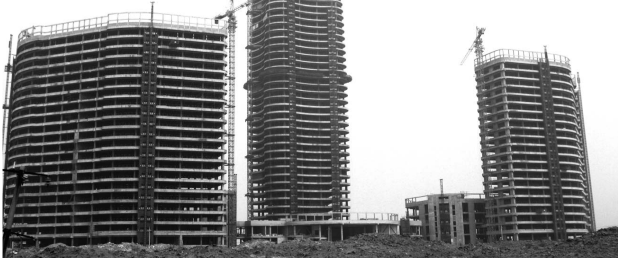
东部新区“三座大厦”主体已封顶,正在进行二次结构建设。 本报记者 王晏坤 摄
