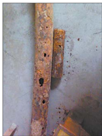
小区内供水管道锈迹斑斑,腐蚀严重。 本报记者 蒋龙龙 摄
