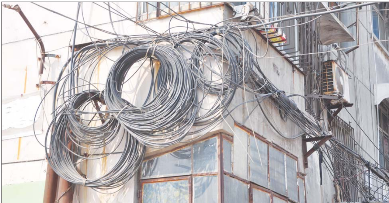
樊家小区的居民楼外,线路被圈成了一推。本报见习记者 王宁晖 摄
