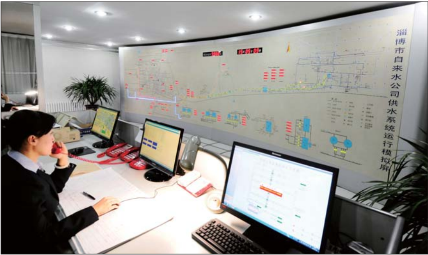
在中心调度室,工作人员观察中心城区供水管网运行情况。 本报记者 王鸿哲 摄
