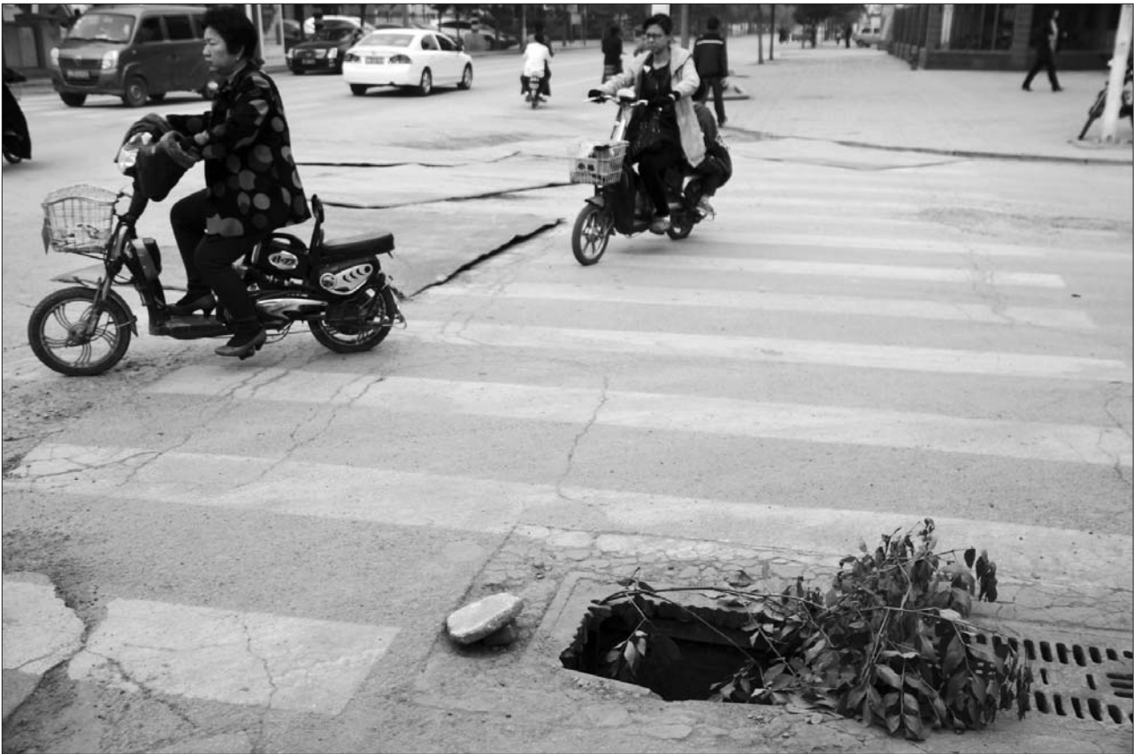
20日,这一路口破损的井算子、坑洼不平的道路给市民带来不便。 本报记者 王小会 摄
