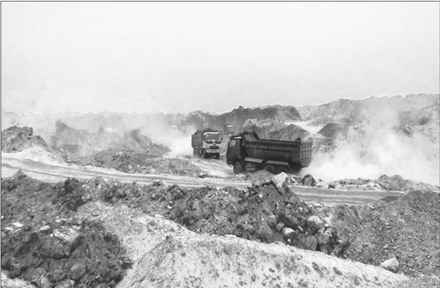
开发区一施工现场，扬尘严重。 通讯员 李金国 摄
