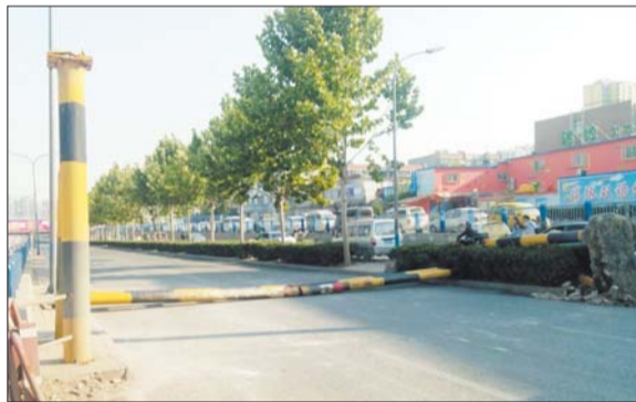
历山路铁路桥南头一处限高杆被齐根撞断,导致北行道路受阻。(热心读者供图)
