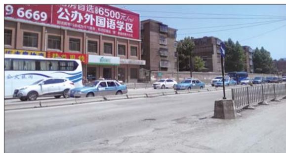
纬十二路路面坑洼,非机动车和机动车全混行。 见习记者 王皇 摄
