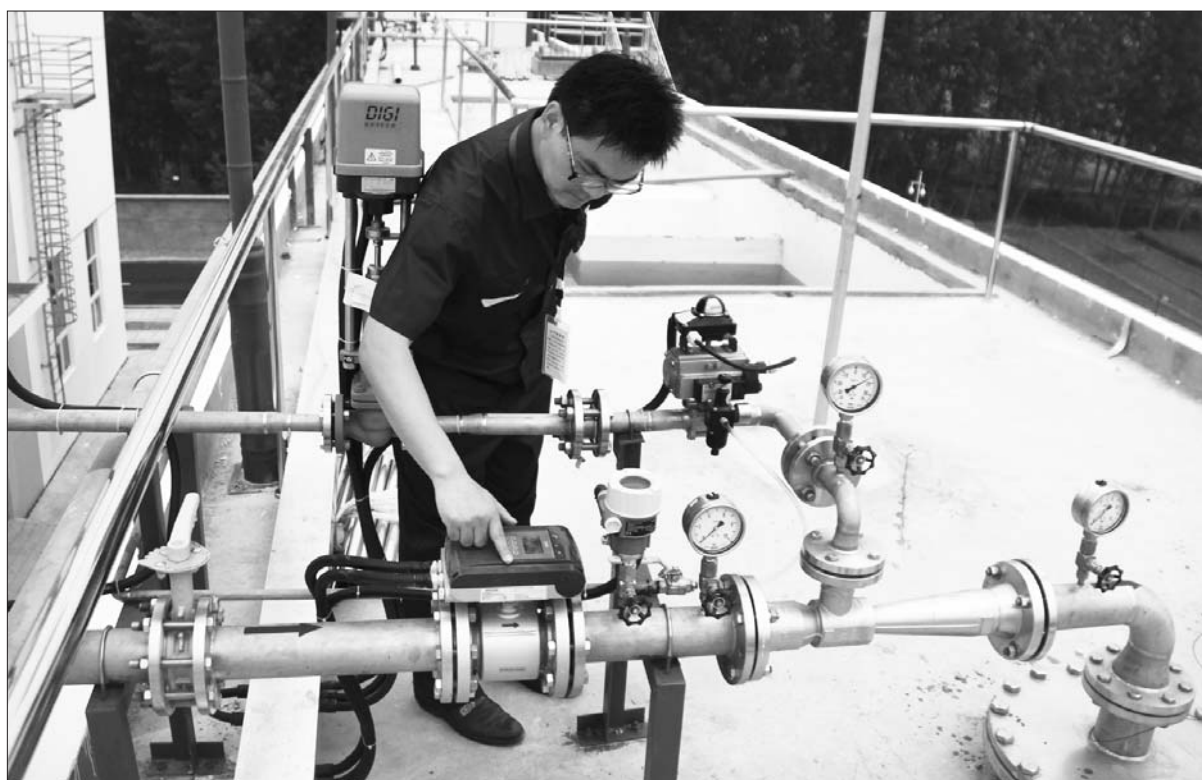
19日,第四水厂竣工仪式在第四水厂内举行。图为供水总公司员工在进水区的配水井处进行压力调试。 本报记者 王小会 摄
