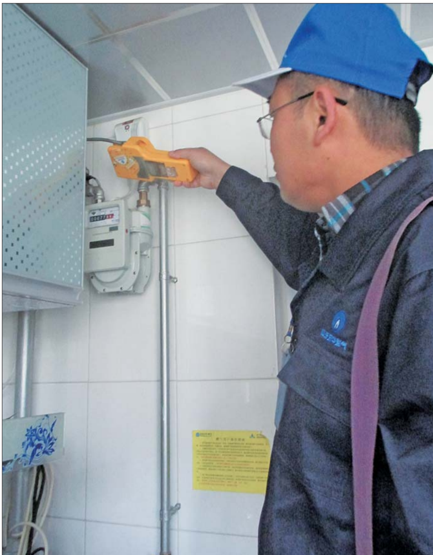
燃气公司工作人员正在对市民家里的燃气设施进行检查。 本报记者 蒋龙龙 摄
