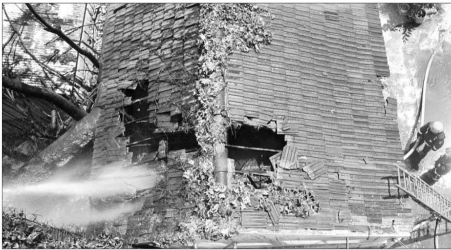
27日,华阳热电一段管道起火,起火点紧挨一处养老院。 见习记者 吕奇 摄
