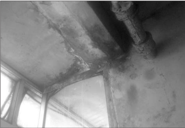
吕女士家的厨房墙角已被污水渗透了。本报记者 刘清华 摄
