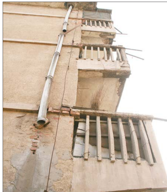
年久失修，小区住房异常破败
