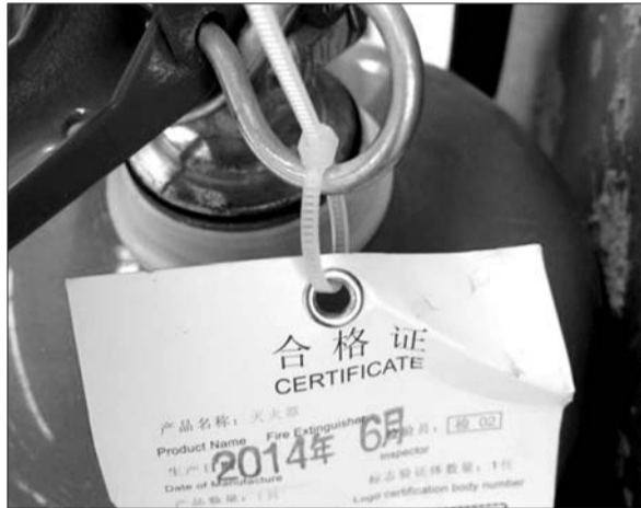
►灭火器上的生产日期为2014年6月。
