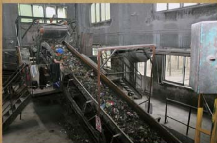
垃圾经过分拣,粉碎将被送到锅炉发电。
