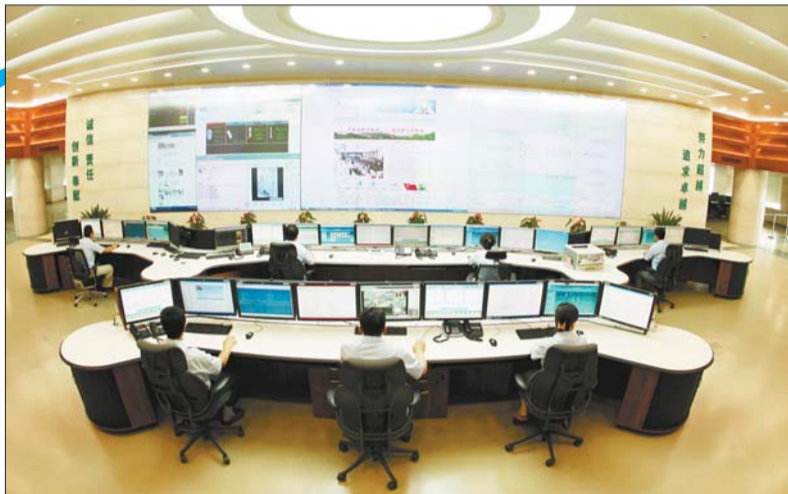
济南供电公司工作人员在调控中心监测电网运行数据。 本报记者 李飞 摄
