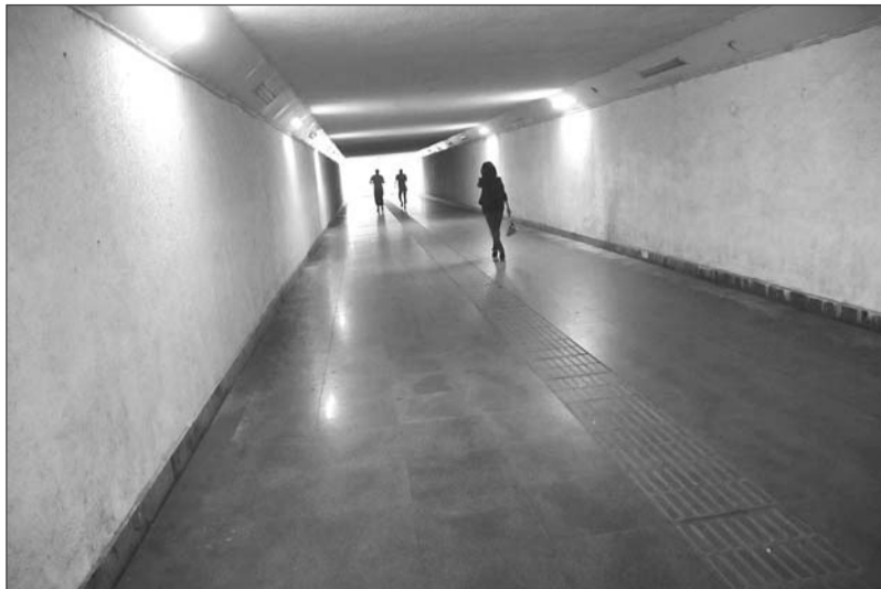
观海路上康惠公司附近的地下通道内,多处灯已坏,里面光线很暗。 本报记者 李泊静 摄
