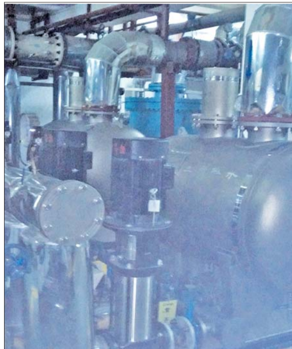
省城一小区的二次供水设施。 本报记者 蒋龙龙 摄
