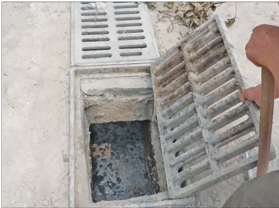
稻香小区雨水管道内厚厚的油脂。
