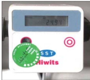
热力计量器上贴的标签显示检定有效期至2013年10月7日
