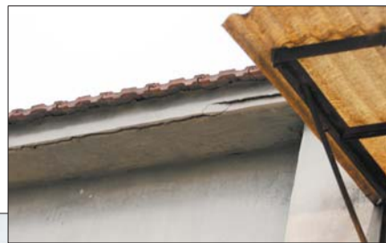
房子上发生裂纹,他说这都是隔壁生产时震的。 本报记者 孙国祥 摄
