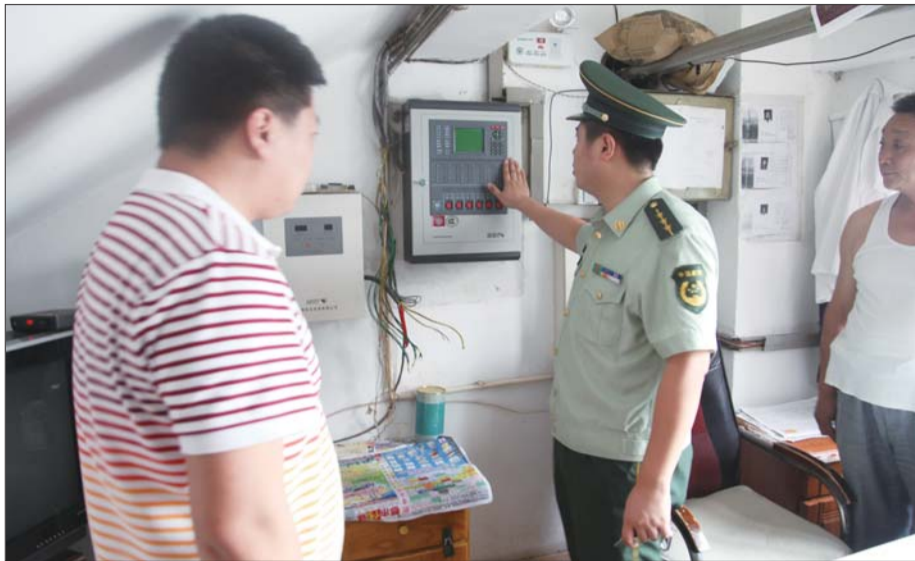
督查人员检查消防控制柜。
